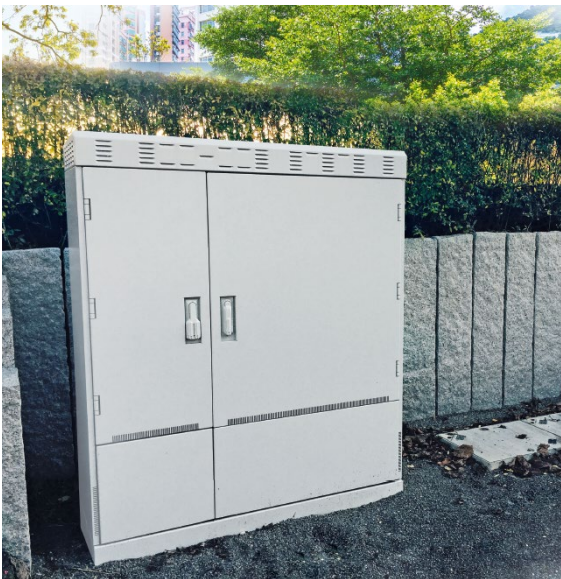
Multifunktionsgebäude für Glasfasertechnik der Firma Connect Com
